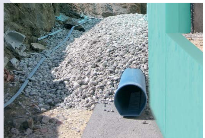
За да се осигури оптимален резултат от поставянето на топлоизолация, препоръчително е да се инсталира подходяща система за дренаж около фундамента на цялия топлоизолиран обект, за да позволи отводняване на дъждовната и подпочвената вода.
