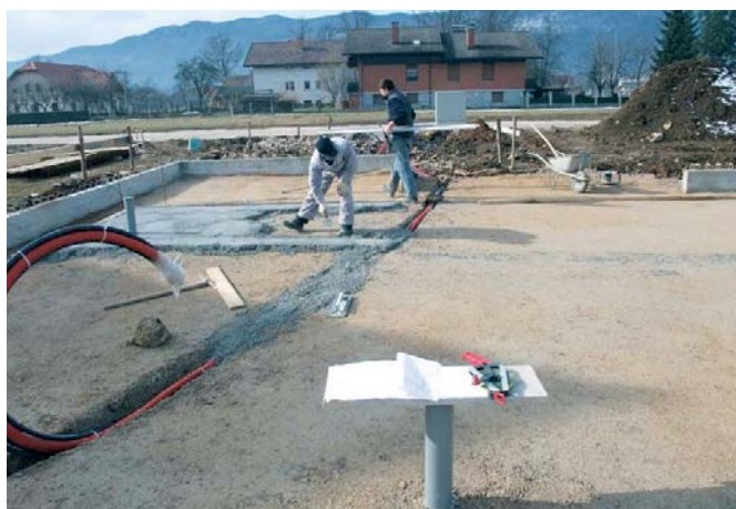
Вертикални и хоризонтални инсталации, уплътняване и изравняване на почвата, върху която ще бъде поставен първият слой топлоизолация FIBRANxps 400-L.
