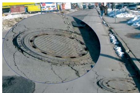
Замръзването на блатиста почва, напоена с вода, причинява щети на пътищата и канализационните системи.
