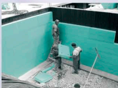
Топлоизолационна защита на вароциментови стени с FIBRANxps 300-L от външната страна на основите
