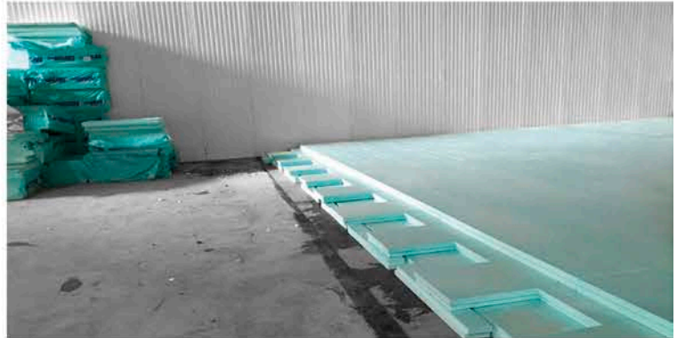
Полагане на FIBRANxps 300-I, FIBRANxps 300-L в конструкция на под, със сух монтаж като топлоизолация
